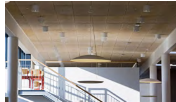
Foto: Na reforma do Brædstrup School, foi dada muita atenção à acústica.
